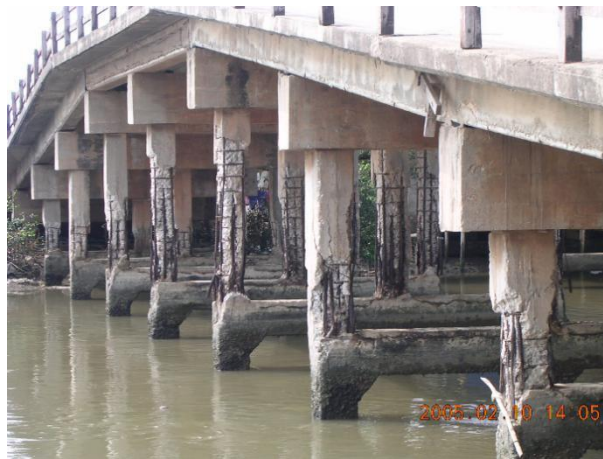
รูปที่ 18 ตัวอย่างความเสียหายระดับ 5 (เหล็กเสริมเกิดสนิม และสูญเสียหน้าตัดอย่างรุนแรงในบริเวณกว้าง จนเป็นอันตรายต่อการรับน้ำหนักบรรทุก เกิดรอยแตกร้าว และหลุดร่อนของผิวคอนกรีตอย่างรุนแรง ประเมินค่าซ่อมแซมแล้วไม่คุ้มค่า เมื่อเปรียบเทียบกับ การหล่อเสาใหม่)
