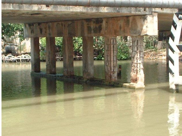
รูปที่ 17 ตัวอย่างความเสียหายระดับ 4 (เหล็กเสริมเกิดสนิมจนสูญเสียหน้าตัดบางส่วนจนเป็นปัญหาในการรับน้ำหนักบรรทุก เกิดรอยแตกร้าว และหลุดร่อนของผิวคอนกรีตค่อนข้างรุนแรง)
