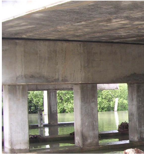
รูปที่ 14 ตัวอย่างความเสียหายระดับ 1 (ความลึกคาร์บอนชั้นยังเข้าไปไม่ถึงตำแหน่งเหล็กเสริม)
