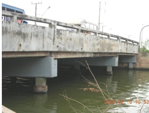
รูปที่ 15 ตัวอย่างความเสียหายระดับ 2 (ความลึกคาร์บอนชั้นถึงตำแหน่งเหล็กเสริมแล้ว แต่ยังไม่ปรากฏความเสียหายที่ผิว)
